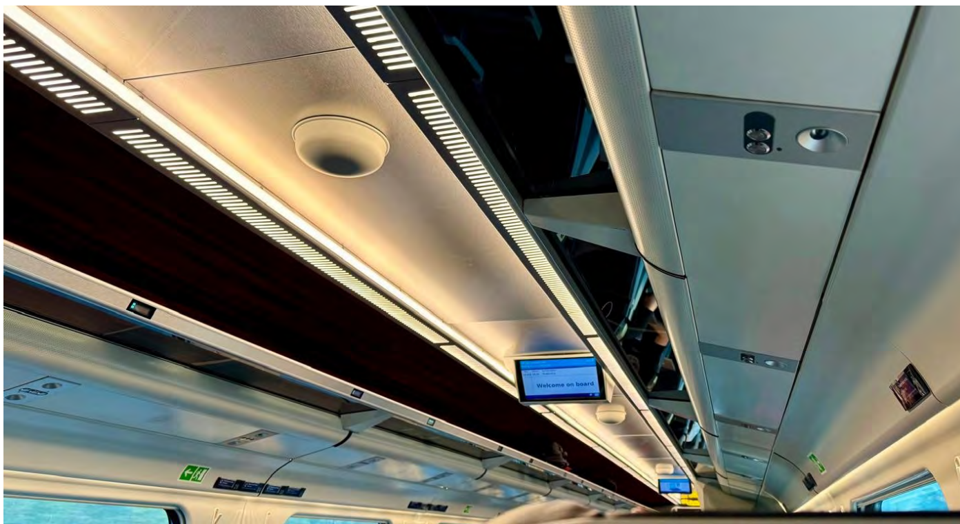
Obrázek 3: Vyzařovací kabely opakovačů mobilního signálu jsou ukryty ve stropní části interiéru vozů. Zdroj: ČD
